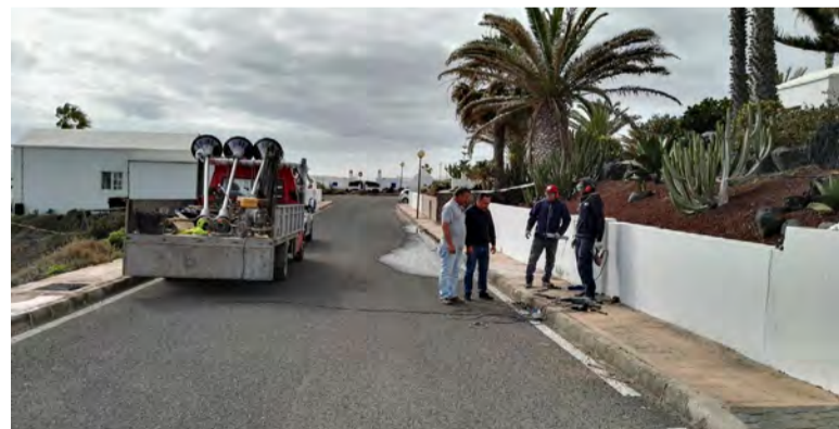
Mejora del alumbrado público en Charco del Palo.
